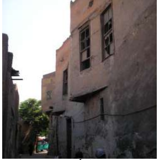
لوحة (٤) الواجهة الشمالية الغربية: المدخل والطابقان الأول والثاني بالواجهة وما بهما من شبابيك وخرجات ويتضح في اللوحة كتلة الإصطبل (بالدرب المسدود)
